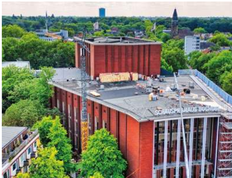
Das Dach des Schauspielhauses wird auf einer Fläche von etwa 700 Quadratmetern modernisiert. Foto: 3satz
