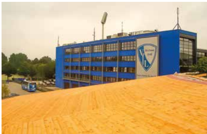
Die Arbeit der Zimmerei Zimmermann ist in der Stadt an vielen markanten Punkten sichtbar: Hier bei der Renovierung der Dachkonstruktion auf der Rundsporthalle unweit des Stadions.
