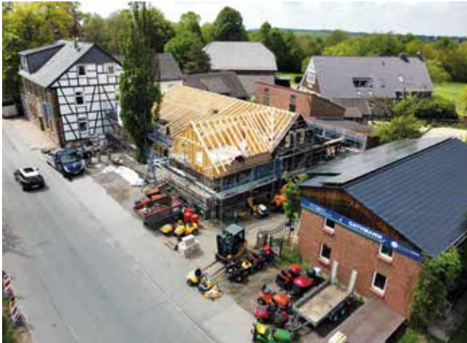
Aus der Drohnen-Perspektive aufgenommen: Rund 150 Quadratmeter Dachfläche werden an der Haarstraße erneuert. Foto: 3satz
