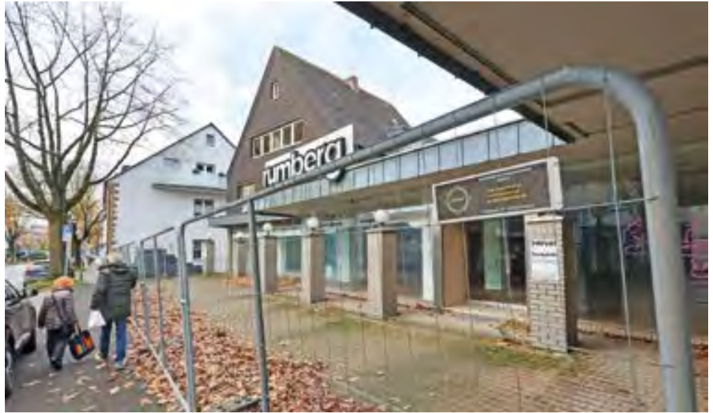
Das ehemalige Möbelhaus wird in Kürze komplett abgerissen. Aldi Nord hat den Komplex erworben und wird an dieser Stelle eine Filiale errichten. Fotos (2): 3satz/Jens Lukas
